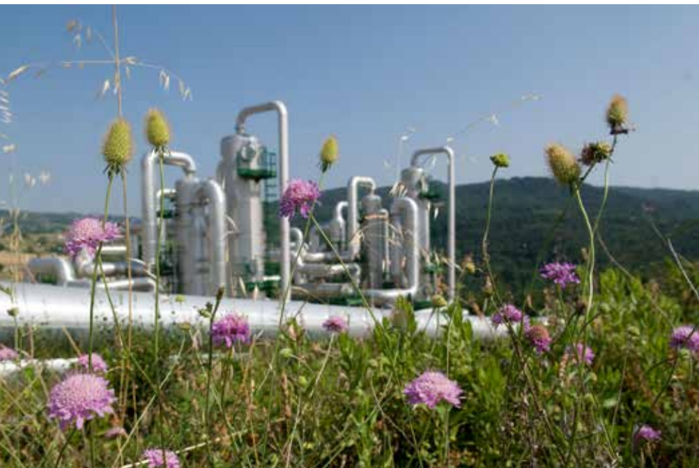
Геотермальная электростанция компании Энель в Италии.
